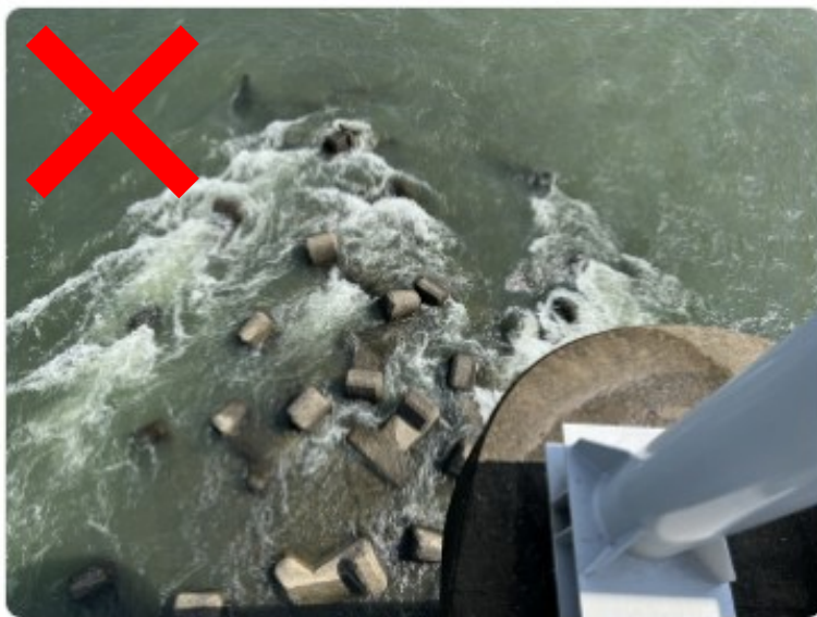
洗掘箇所は近接が困難
