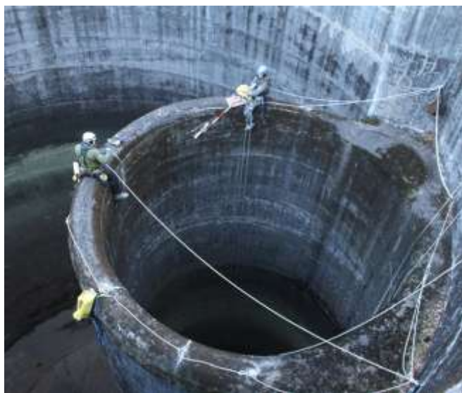
水力3：水力発電所調圧水槽 - コンクリート変状調査
