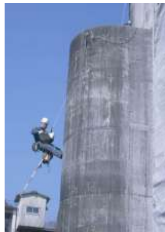
水力5：ダムゲートピア部 - コンクリート変状調査
